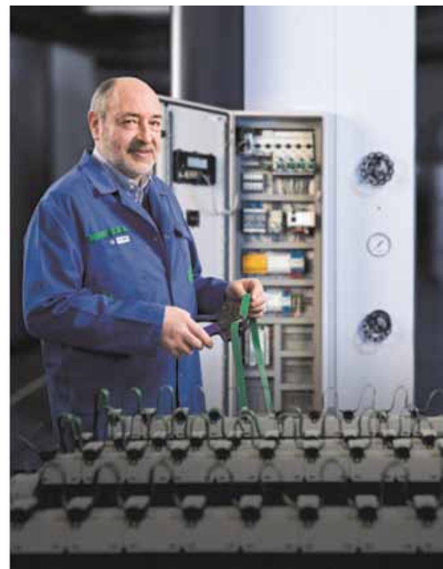
Použití technologie inteligentního komunikačního systému snižuje pracnost zapojení a šetří prostor.
