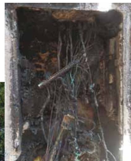
Obr. 1b Vyhořelý rozvaděč
