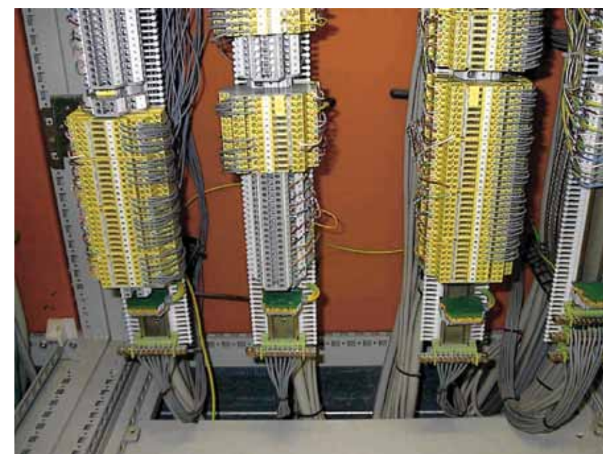
Obr. 9 Svodič přepětí DCO ME 24 v rozváděči [1]
