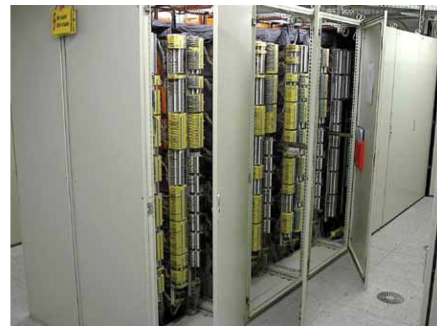
Obr. 8 Svodič přepětí DCO ME 24 v rozváděči MaR [1]
