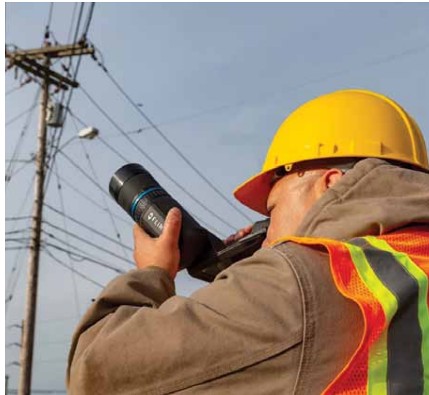
Kontrola venkovních elektrorozvodů termokamerou FLIR T840
