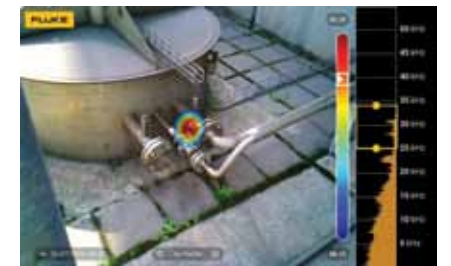
Únik plynu na špatně těsnícím ventilu potrubí
