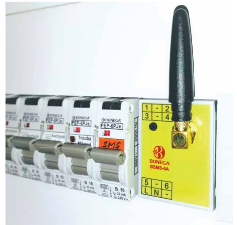
Obrázek 2 - Signalizátor v rozvaděči spolu s dalšími přístroji
