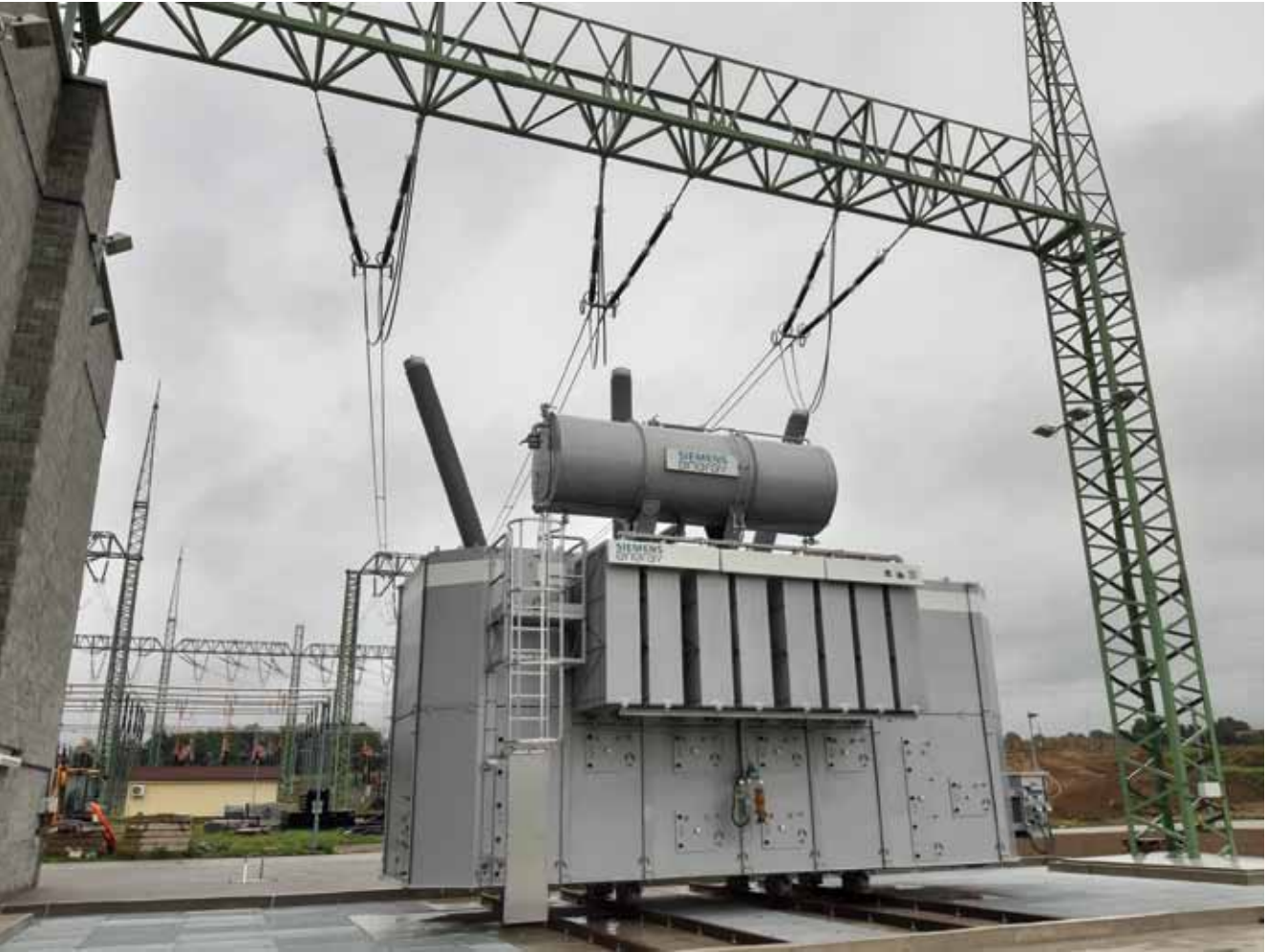
Obr. 3: Tlumivka Mírovka (HBM) TL401 po ukončené montáži
