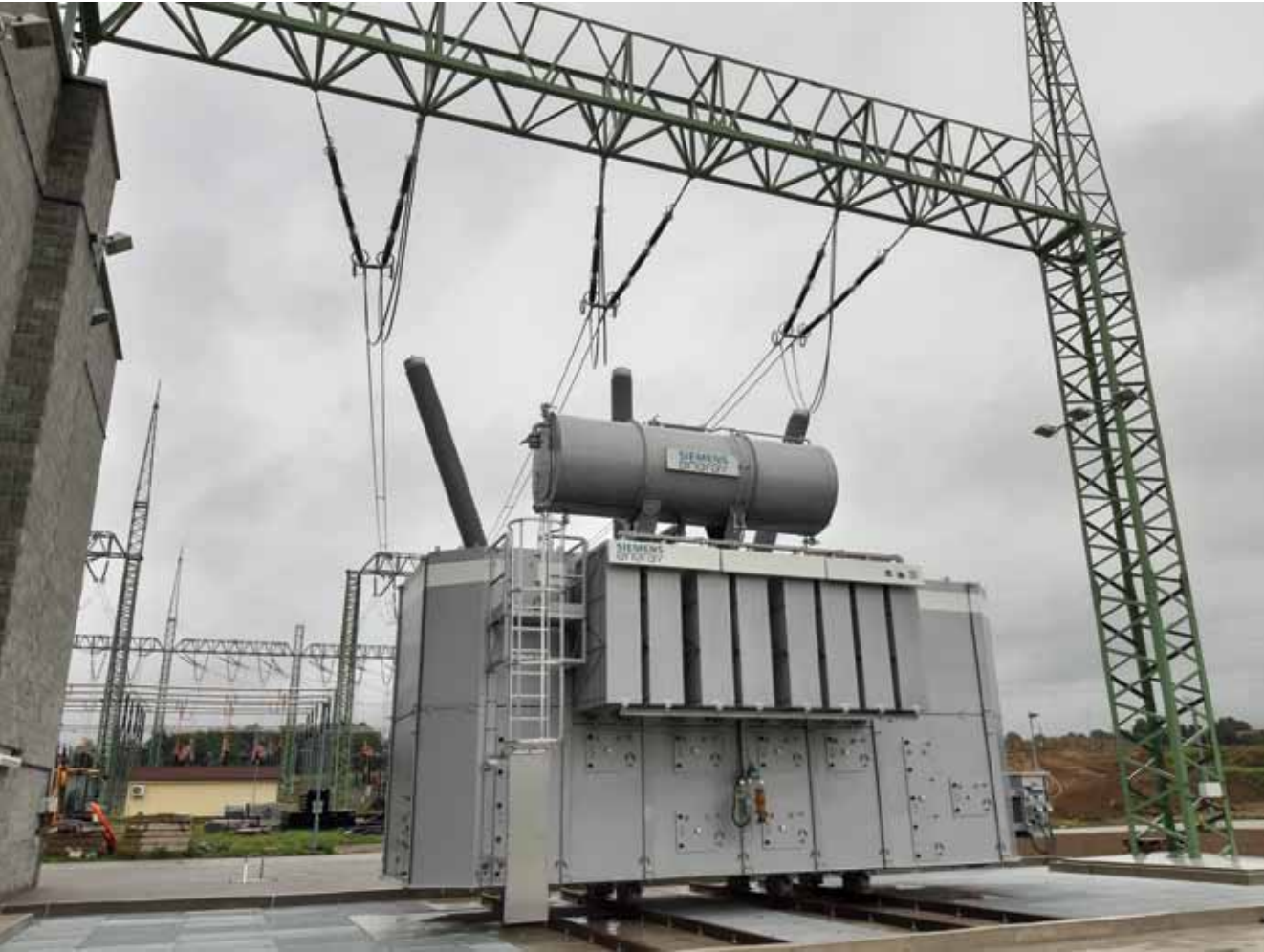
Obr. 3: Tlumivka Mírovka (HBM) TL401 po ukončené montáži
